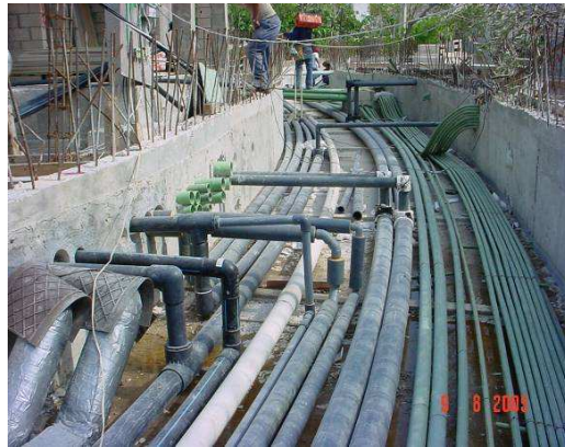
Figura 18: Instalaciones de trinchera. Por: LAAG.
